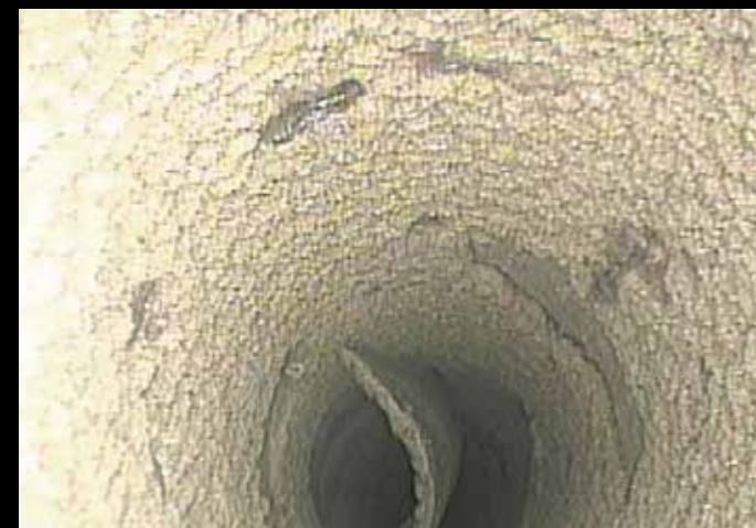
ボイラ内部(水管)スケール付着
