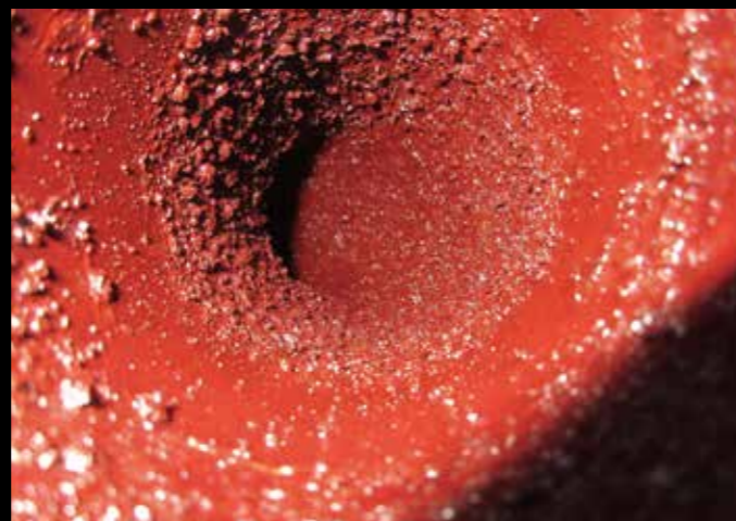
腐食(もらい錆から発生)
